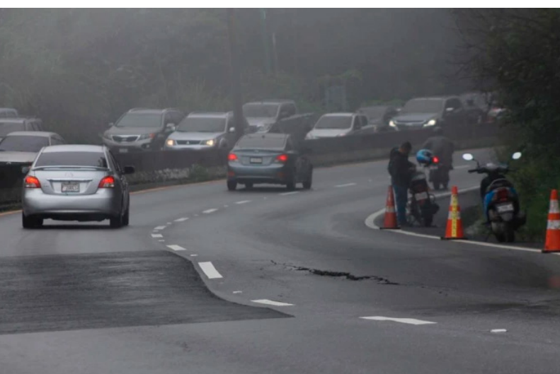
Foto: Hundimiento en carretera a El Salvador
