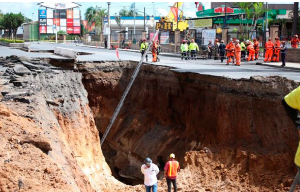
Foto: Socavamiento en Villa Nueva
