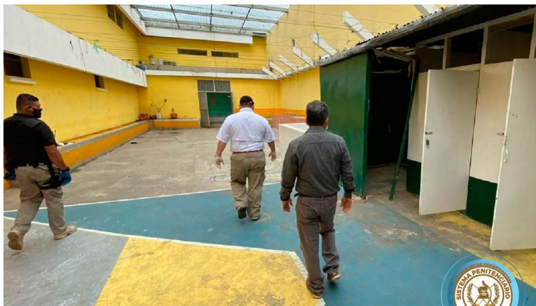
La imagen proyecta el deterioro de la infraestructura en el centro preventivo de la zona 18. (Fotografía Dirección General del Sistema Penitenciario).
